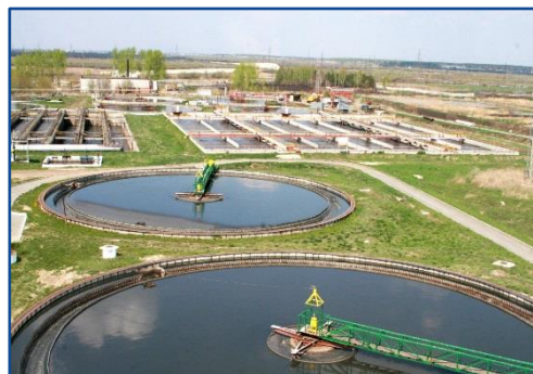
Очистные сооружения водоканалов.
