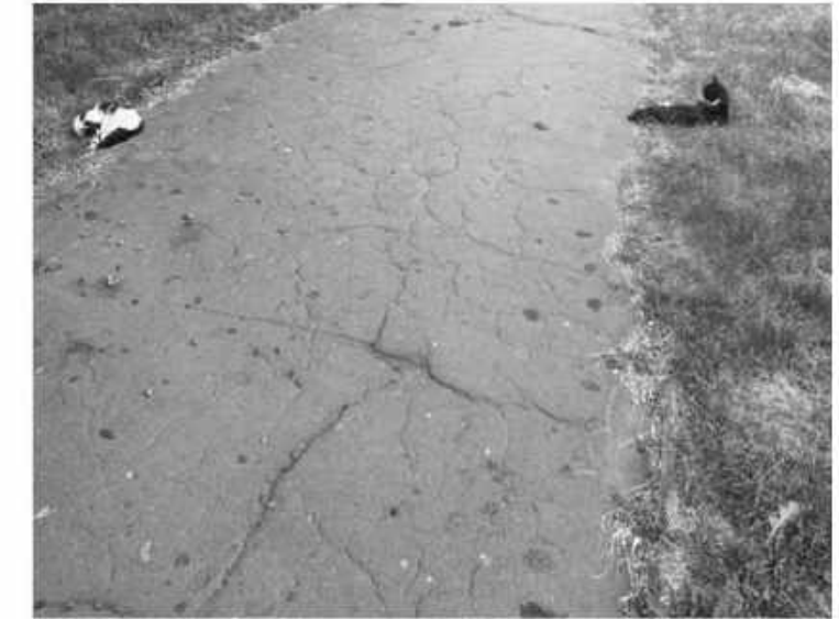
4 Изношенная тротуарная дорожка
